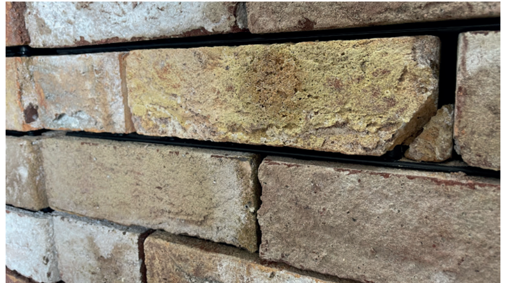
Kapotte steen in de gevel
