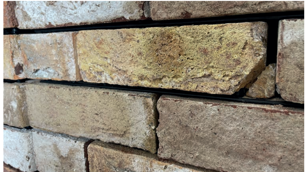
Kapotte steen in de gevel
